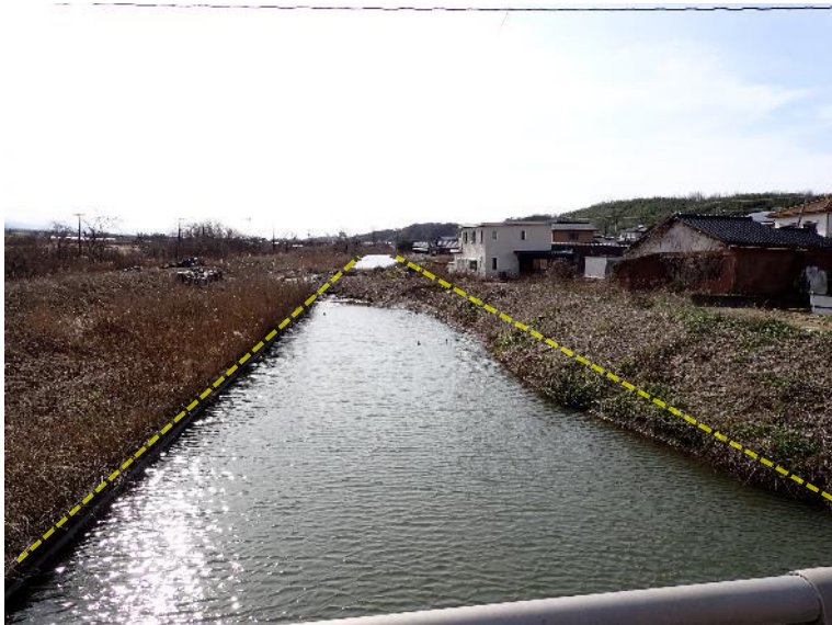
水路閉塞：内灘町室
