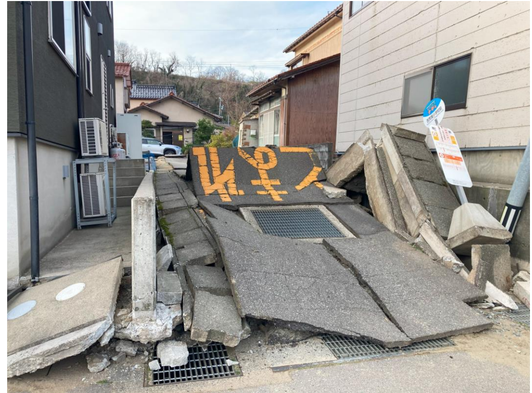
県道沿の砂丘側側道の変形（隆起）の様子
