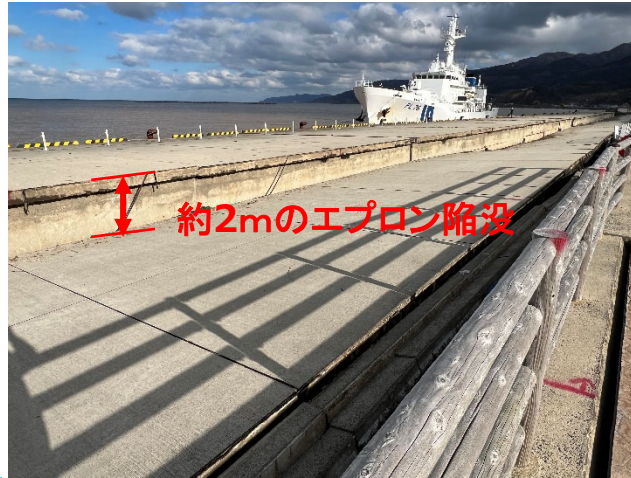
1.2 岸壁エプロン陥没状況【輪島マリンタウン岸壁】
