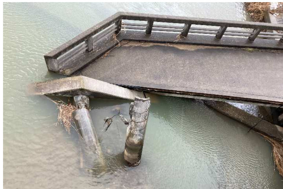
パイルベント式橋脚の折損による落橋
